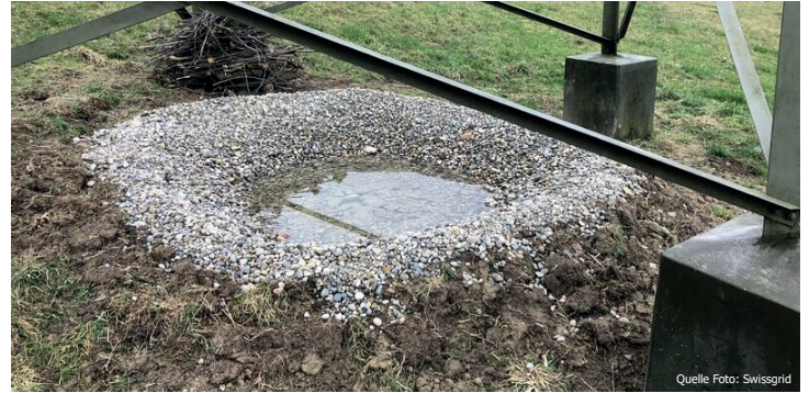
Freileitungsmasten mit einer Kombination verschiedener Kleinstrukturen.
